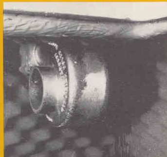
Ventilation forcée de la chambre moteur.
